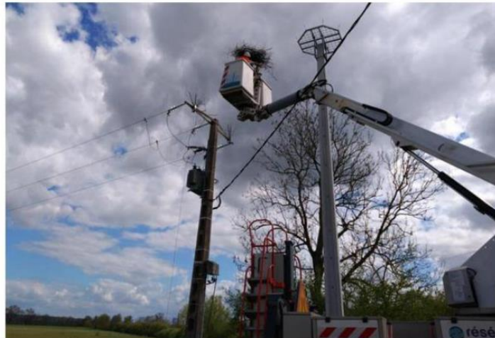
Déplacement d'un nid de cigognes par les agents de Réséda, mercredi 10 avril, à Sanry-sur-Nied. Photo Réséda
