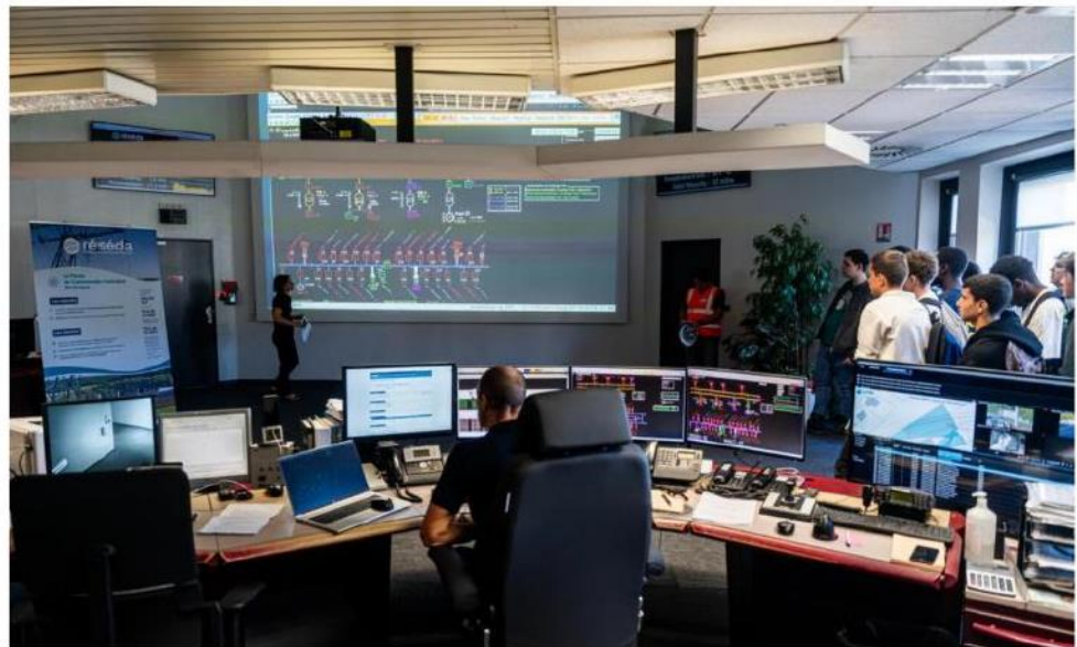
Au Pontiffroy est installé le siège de Réséda, avec le poste de commande centralisé, qui a une vue sur l'ensemble du réseau. Photo Hugo Azmani
