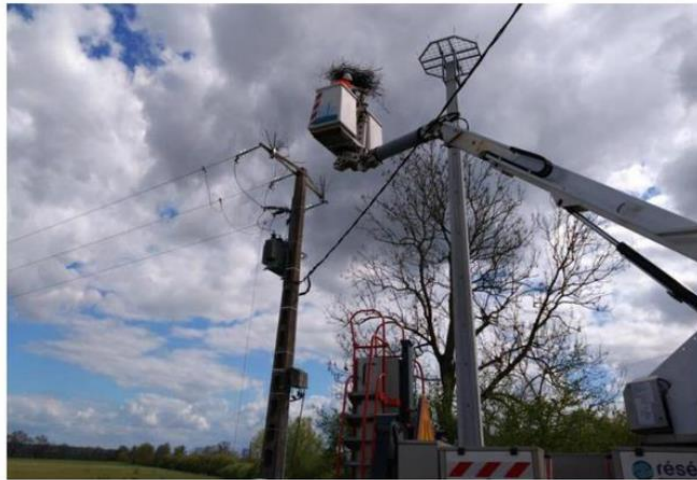
Déplacement d'un nid de cigognes par les agents de Réséda, mercredi 10 avril, à Sanry-sur-Nied. Photo Réséda
